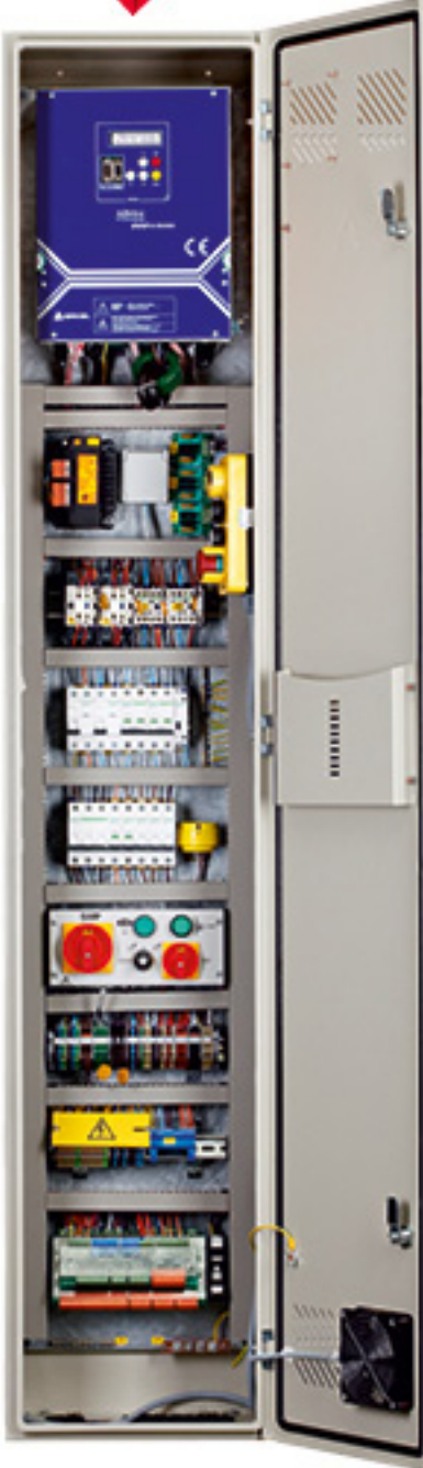
Dişlisiz Pano Gearless Control Panel لوحة التحكم بدون تروس
